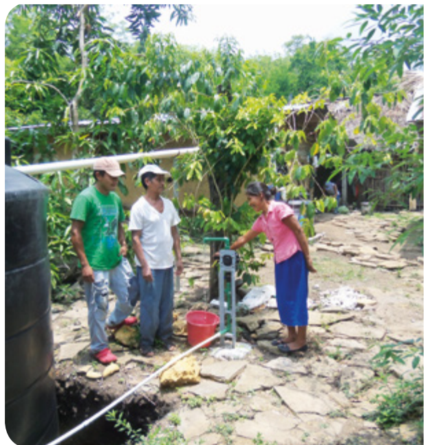
Captación de agua de lluvia en El Chote, Tampamolón.
