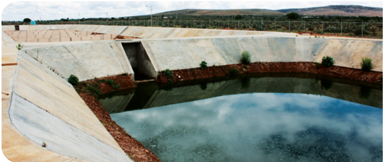
Planta de tratamiento de aguas residuales El Tepetate, Villa de Arriaga.
